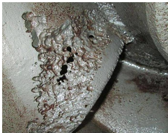
Gambar I. 2 Erosi dan lubang pada sudu impeller akibat kavitasi [6].
