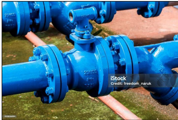
Gambar 1.1.1 ball valve digunakan di sistem irigasi[2]
